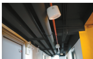
走廊中应急灯、喷淋等设施一应俱全(红色管线为喷淋的进水管)。
